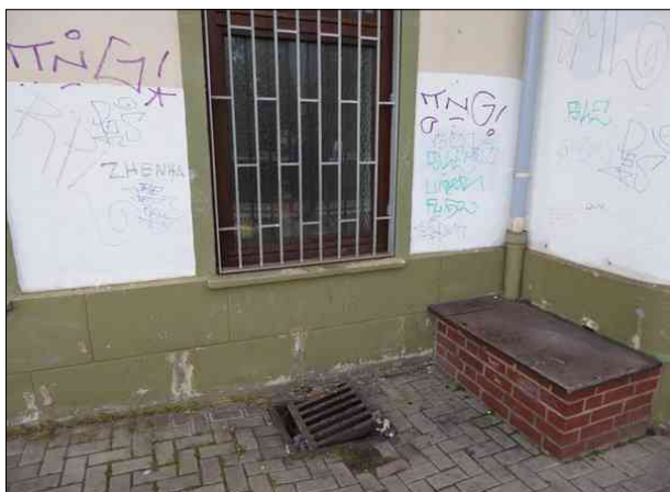
Abbildung 22: In Pinneberg war an Gleis 3 nicht nur die Fassade des Bahnhofsgebäudes beschmiert, sondern auch ein Gullideckel verschoben.
