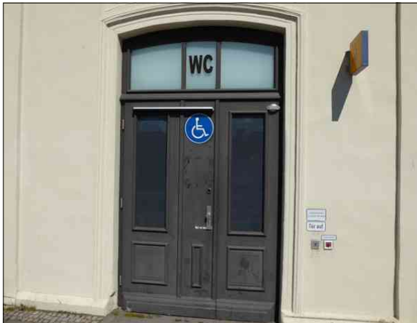
Abbildung 37: Das direkt vom Bahnsteig zugängliche Behinderten-WC in Plön wurde wegen wiederholter Vandalismusschäden dauerhaft geschlossen.
