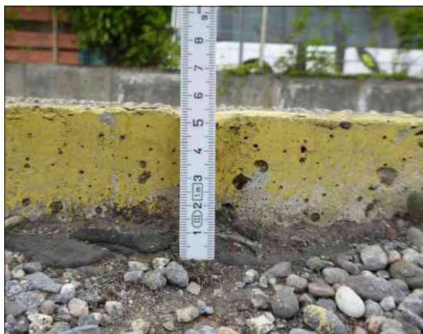
Abbildung 5: Vor den Bahnsteigkanten in Bredstedt sind durch Absackungen stellenweise mehr als 5 cm hohe Stufen entstanden.
