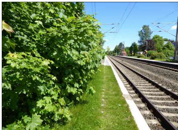
Abbildung 49: Im Bereich der Rasenoberfläche wucherten Pflanzen weit in den Lichtraum des Bahnsteigs an Gleis 1 in Flintbek.
