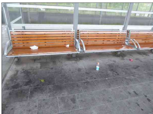
Abbildung 6: In Rendsburg waren die Bahnsteigoberflächen in den Wartebereichen stark verschmutzt.
