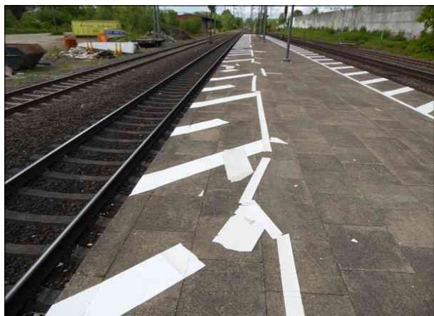
Abbildung 50: Die im Winter aufgebrachte Gefahrenbereichsmarkierung auf dem Mittelbahnsteig in Pinneberg löst sich großflächig ab.
