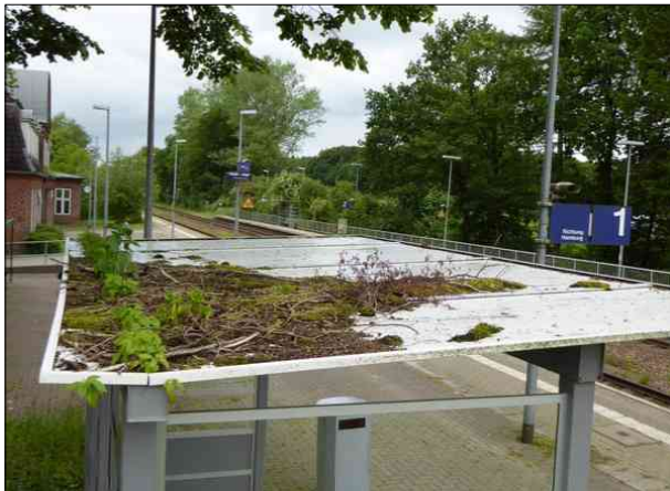
Abbildung 7: Das Dach dieses Fahrgastunterstands in Burg (Dithm) ist stark bewachsen. Dadurch wird der Wasserabfluss behindert.
