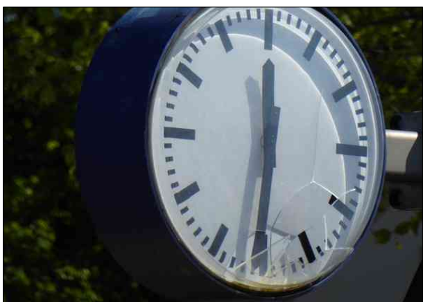
Abbildung 24: An der Bahnsteiguhr an Gleis 1 in Preetz wurde das Glas zerstört. Auch das Uhrwerk funktionierte nicht mehr.
