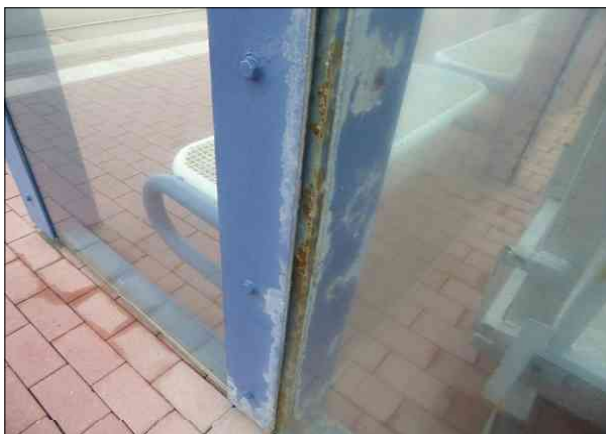
Abbildung 9: Lackschäden und Rostbildung sind an den Stützen des Wetterschutzes auf dem Bahnsteig in Dagebüll Mole unübersehbar.
