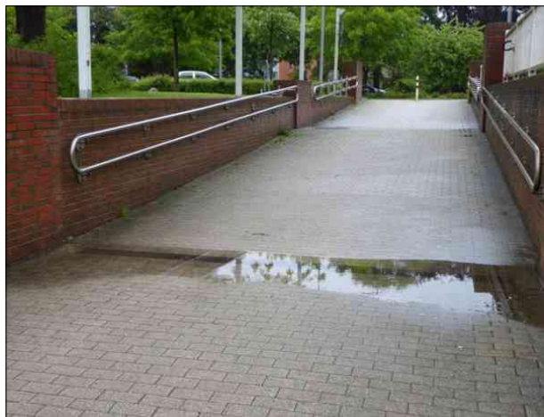
Abbildung 44: Am Zugang zur Unterführung in Schleswig bilden sich regelmäßig an mehreren Stellen aufgrund verstopfter Wasserabläufe größere Pfützen.
