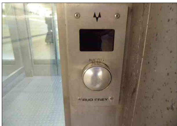
Abbildung 45: Der Aufzug zu den Gleisen 6/7 in Bad Oldesloe war defekt. Nicht an allen Bedientasten wurde das wie vorgesehen angezeigt.
