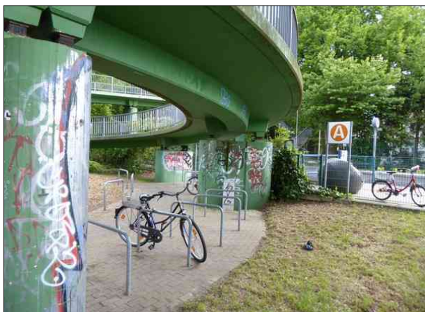
Abbildung 23: Die beschmierten Stützen der städtischen Überführung beeinträchtigen das Erscheinungsbild der Station Friedrichsgabe in Norderstedt.
