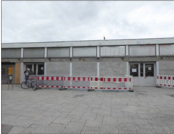
Abbildung 34: Durch den Abbau des Vordachs mit der Beschilderung präsentieren sich die Eingänge zum Empfangsgebäude von Elmshorn wenig einladend.
