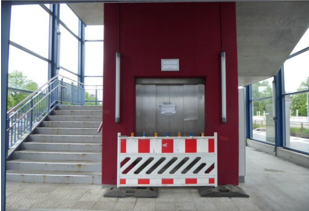
Tornesch: Bahnhof an der Strecke Hamburg - Elmshorn. Seit fast zwei Jahren müssen die Fahrgäste schon auf die Aufzüge verzichten.
