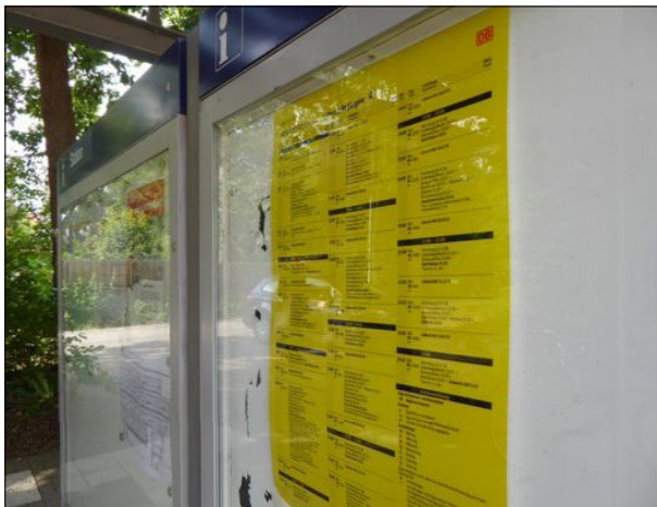
Abbildung 29: Die Rückwand der Fahrplanvitrine in Lübeck-St. Jürgen ist etwas beschädigt.
