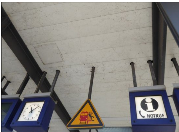
Abbildung 50: Die Unterseite des Bahnsteigdachs in Reinbek war bereichsweise verschmutzt.
