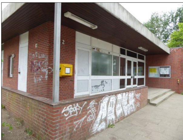
Abbildung 36: Das Empfangsgebäude des Bahnhofs Tönning ist außen seit Jahren bekrizelt und beschmiert.
