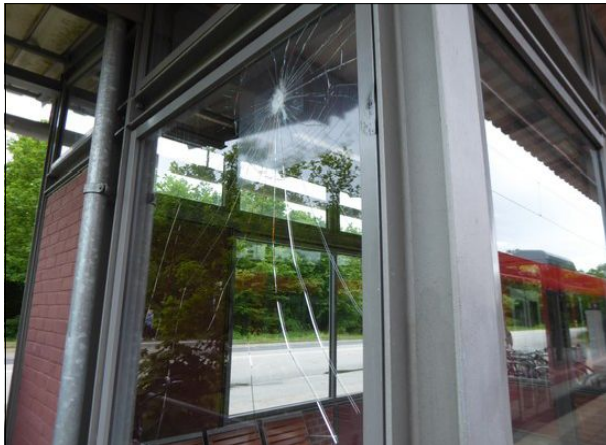
Abbildung 22: Eine Scheibe der Wartehalle in Lübeck-Kücknitz wurde mutwillig beschädigt.
