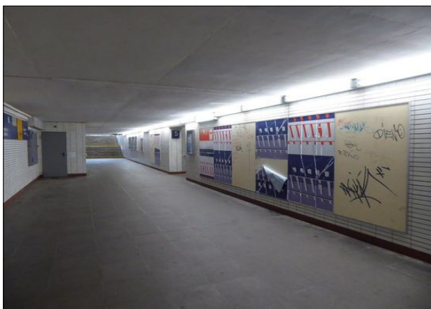
Abbildung 45: In Pinneberg waren zum wiederholten Mal einige Tapeten des Graffiti-Schutzboards im Tunnel abgerissen.
