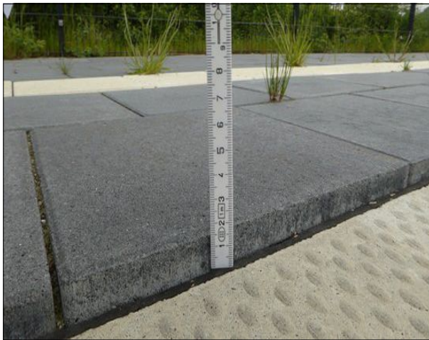
Abbildung 5: Die seit Inbetriebnahme Anfang 2015 auf größerer Länge mehr als einen Zentimeter hochstehenden Platten des Bahnsteigs in Schülldorf wurden immer noch nicht an das Niveau der Bahnsteigkante angepasst.
