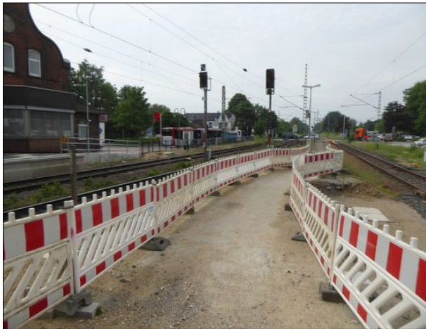
Abbildung 44: Da der neue Aufzug in Wrist nicht funktionierte, mussten Rollstuhlfahrer den noch provisorisch erhaltenen Überweg über die Gleise mit Freigabe durch die Fahrdienstleiterin benutzen.
