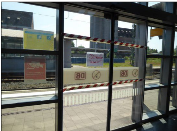
Abbildung 53: Im Bahnhof Bad Oldesloe war die Automattür von der Empfangshalle zu Gleis 3 defekt und gesperrt.
