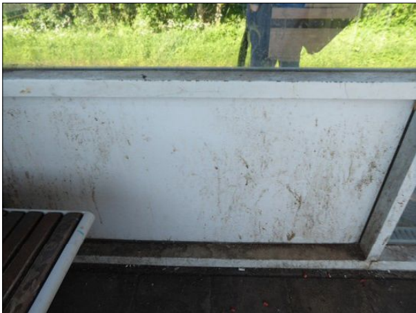
Abbildung 8: Die Brüstung der Wartehalle in Wahlstedt war stark verunreinigt.
